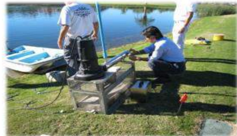
ロサンゼルス・ゴルフ場池浄化工事 CATHと空気注入攪拌装置を併用
