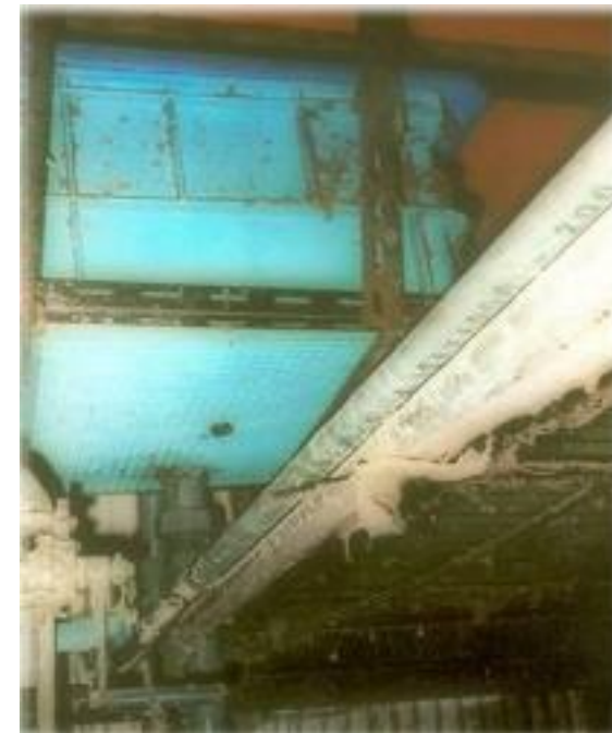
CATH設置済み給水タンク
